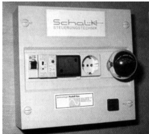
Abb. 22: EINGEBAUTER NETZFREISCHALTER IN EINEN ELEKTROVERTEILER-KASTEN (RECHTS NEBEN DER SICHERUNG) (KÖNIG 2000)
